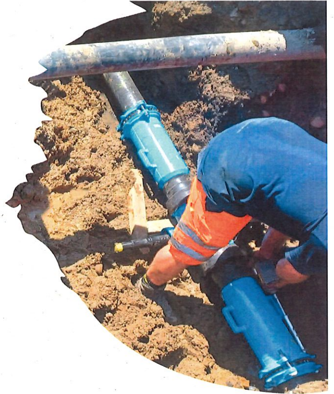
September Rohrleitungsbruch KGZ Meggen
